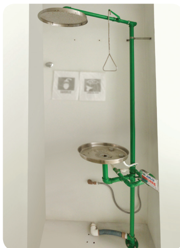
Figura 5 – Chuveiro de emergência com lava-olhos acoplado.
